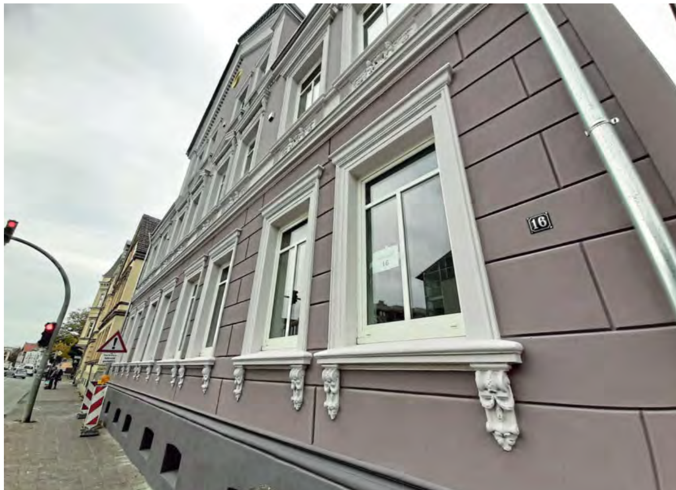
An der Neuhäuser Straße ist das Doppelhaus mit den Hausnummern 16 und 18 kernsaniert worden. Die historische Fassade wurde weitestgehend erhalten und restauriert.
